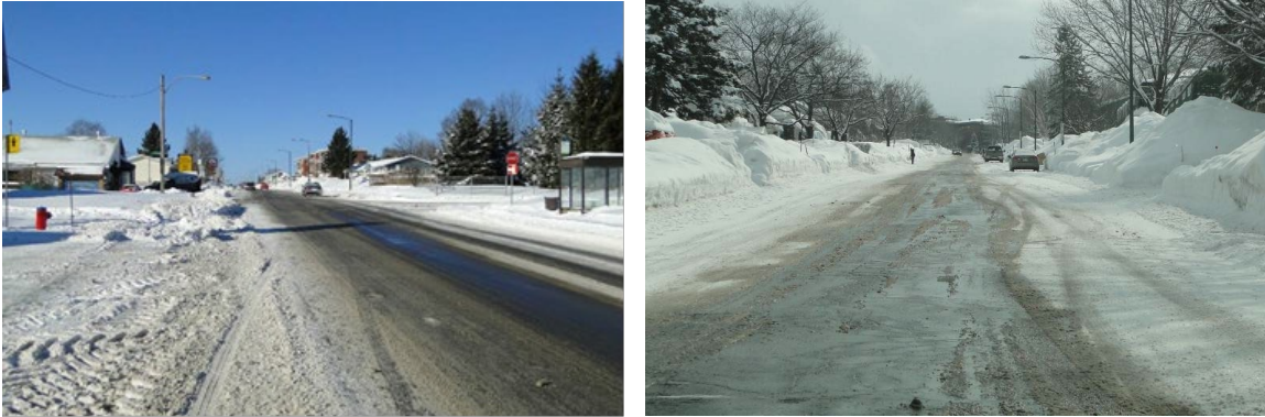
Photo 1 et 2 : état de surface centre au pavage sur une route.
