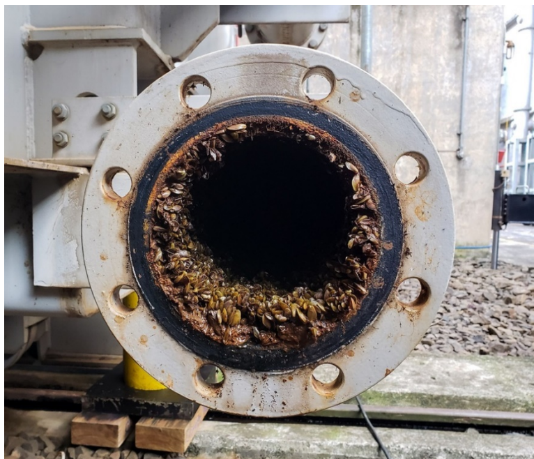
Conduite de prise d'eau envahie de moules zébrées
